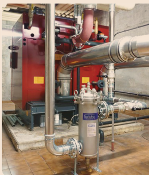
Filtro IDRAMAG installato in centrale termica
